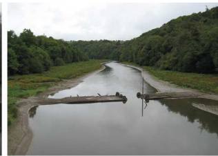
3. Mars 2015 : le plan d'eau n'a pas été remonté à sa cote estivale pour faciliter le ressuyage des sédiments déposés sur les bords de la retenue en vue d'assurer une portance satisfaisante aux engins devant, par la suite, réaliser les travaux de gestion sédimentaire. On remarque que quelques mois d'abaissement ont suffi pour que la végétation recolonise les berges.
