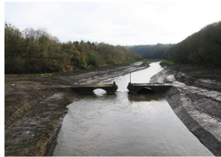
8. Novembre 2017 : les travaux d'extraction des sédiments du lit mineur sont terminés, les banquettes sont réalisées. C'est maintenant à la Sélune de se réapproprier son lit mineur et ses berges par son propre écoulement lui redonnant un aspect naturel.
