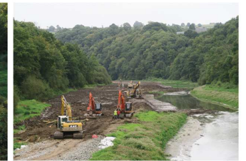
5. Juillet 2017 : les premiers travaux de reprofilage du lit mineur historique ont débuté. Les pelleteuses commencent à extraire les sédiments qui se sont déposés dans le lit mineur de la Sélune au cours des décennies. Ceux-ci sont stockés en rive droite, sur le lit majeur, dans les limites de la retenue.
